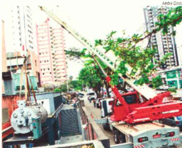
Há 14 anos na ativa, equipamento já apresentava problemas
